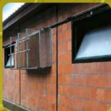
Системы вентиляции и кондиционирования с автоматическими окнами
